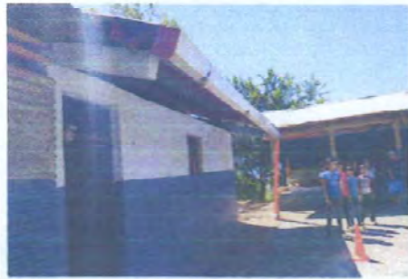
Foto 1: canales y bajada de agua pluvial
